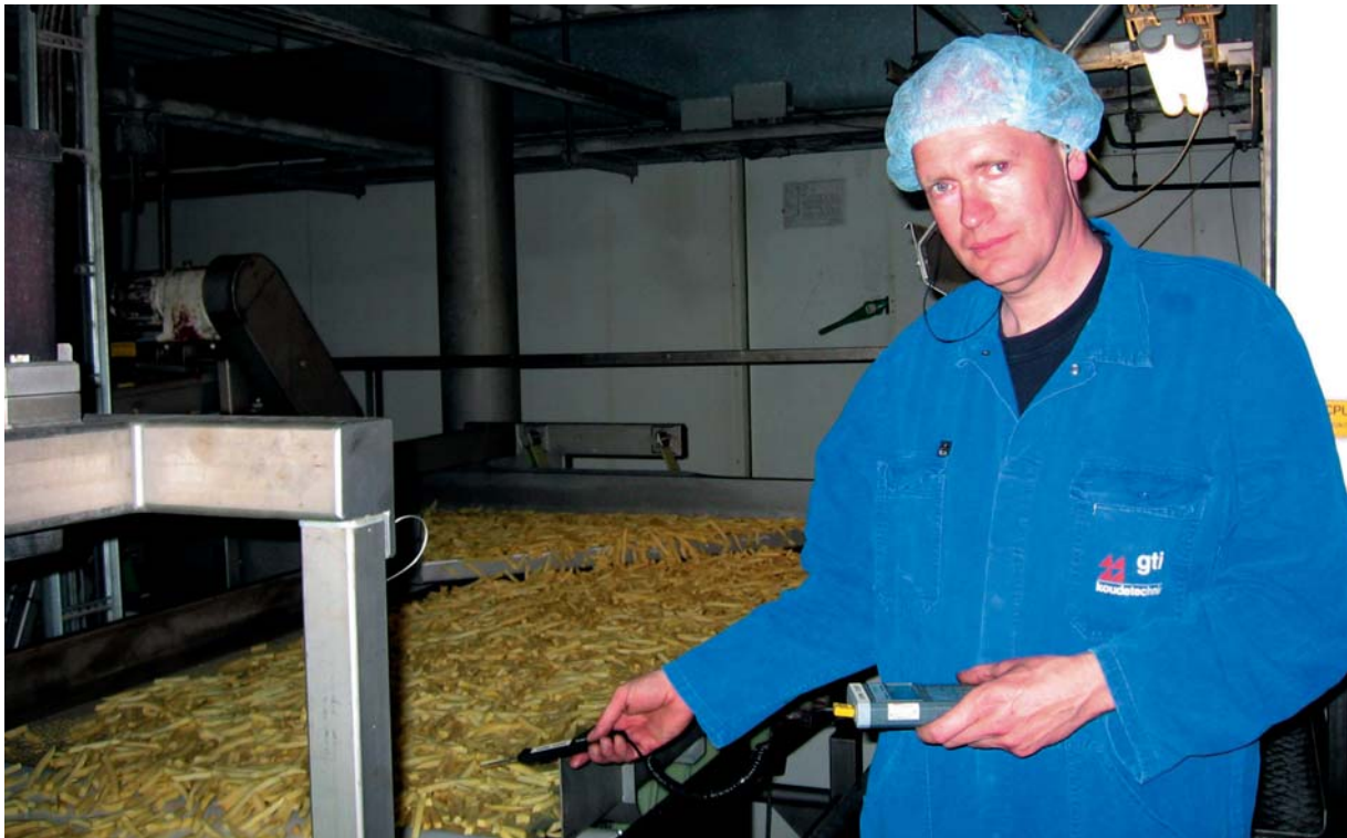
Uitbesteding van onderhoud bij Aviko. Een monteur van GTI controleert een luchtkoeler bij de geconditioneerde sorteerruimte van patat frites.
