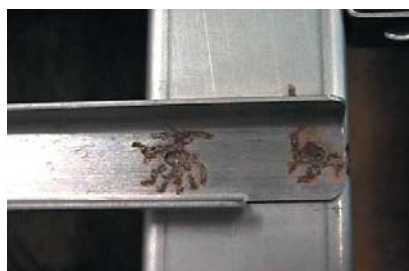
Fig. 2 Lokale corrosie van roestvast staal (spanningscorrosie rond puntlassen).
