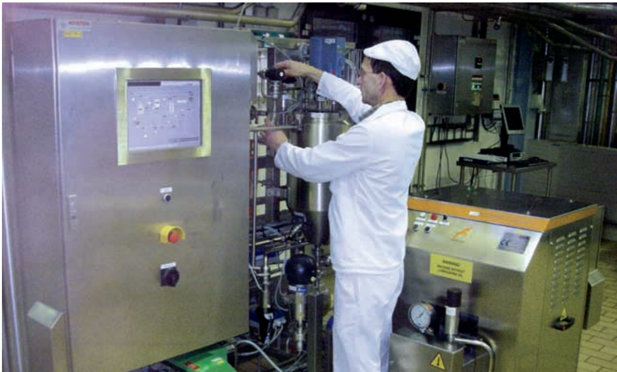
De mini-membraanunit, zoals deze door NIZO is ontworpen en gebouwd.
